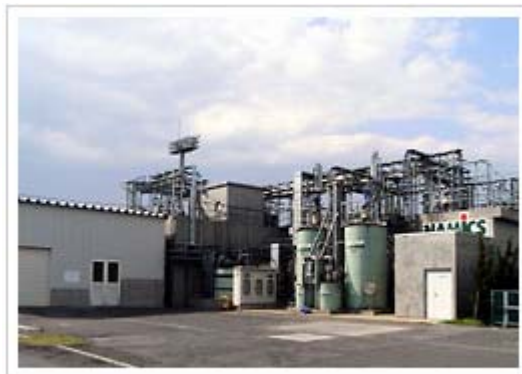
排水処理施設(本社工場)
